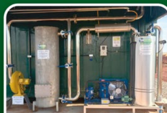
SISTEMA DE TRATAMENTO DE BIOGÁS
